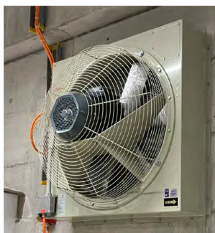
Ventilator einer Rauch- und Wärmeabzugsanlage.
