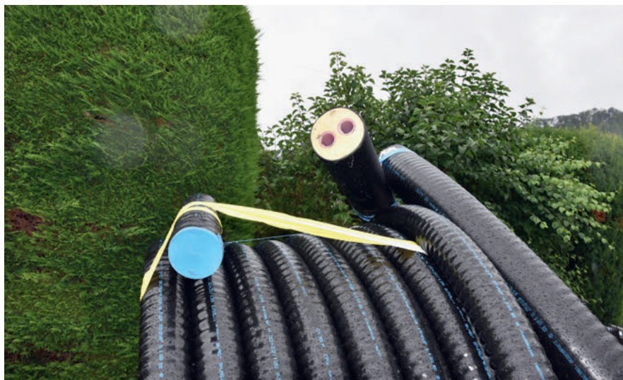
Das Heisswasser und das abgekühlte Wasser werden durch ein duales Rohrsystem zu- bzw. wieder abgeführt.
