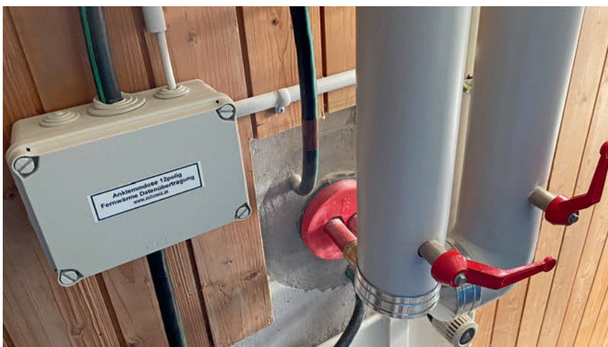
Links im Bild ist die Anschlussdose, die die Kommunikation mit der Zentrale sicherstellt. Ganz rechts befinden sich die Absperrarmaturen. Hinten (Mitte) ist der Eintrittspunkt der Fernwärme- und der Kommunikationsleitungen.
