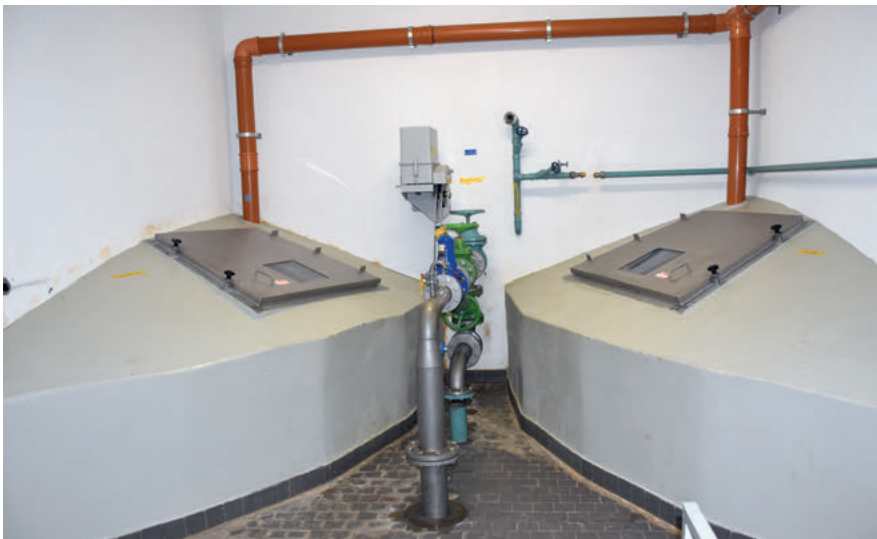
Die kleinen Glasscheiben bieten Einblick in die beiden Wasserkammern im Reservoir Ost.
